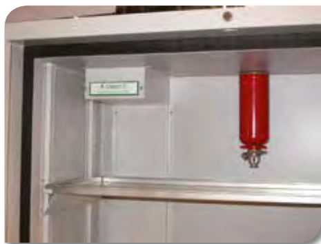
Apparecchio estintore Installato in un armadio di sicurezza
